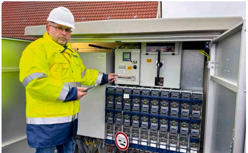
Routiniert an der Trafostation: Mathias Fett, Abteilungsleiter Bereich Netze
